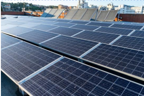
Plaques solars de l'Escola Municipal de Treball
