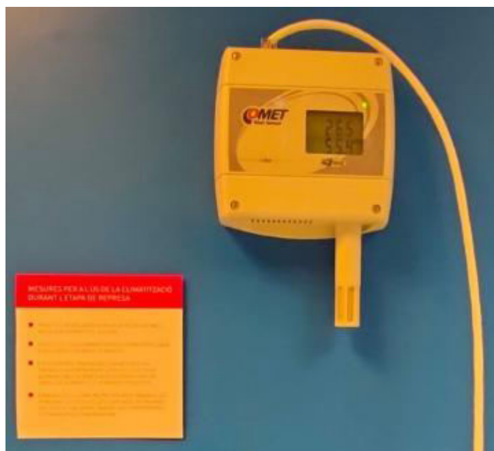
Senyalització de mesures per l'ús de la climatització i la ventilació en el retorn al treball presencial, i equip de mesura de les condicions ambientals instal·lat als edificis d'oficines. Font: Servei de Medi Ambient i Espais Verds
